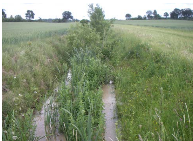
Ett dike med kraftig vegetation och i ett stort behov av underhåll. Foto: Anuschka Heeb
